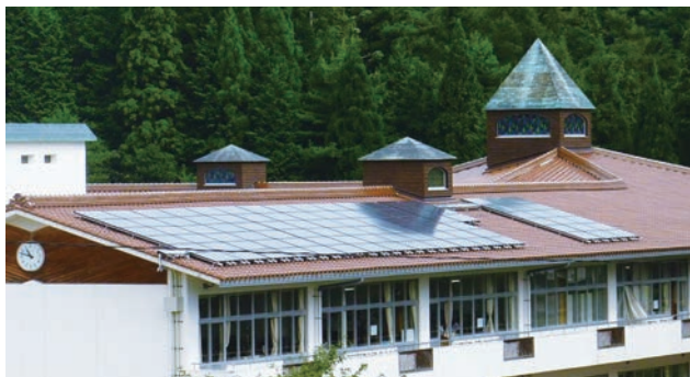
図5 来島小学校に設置された太陽電池
