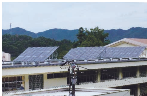
図 3 赤名小学校に設置された太陽電池
